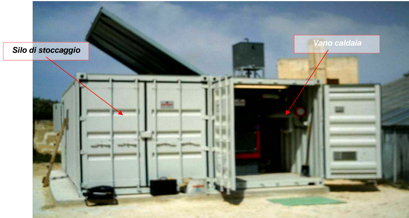
Centrale termica prefabbricata: impianto di riscaldamento di una serra di produzione
