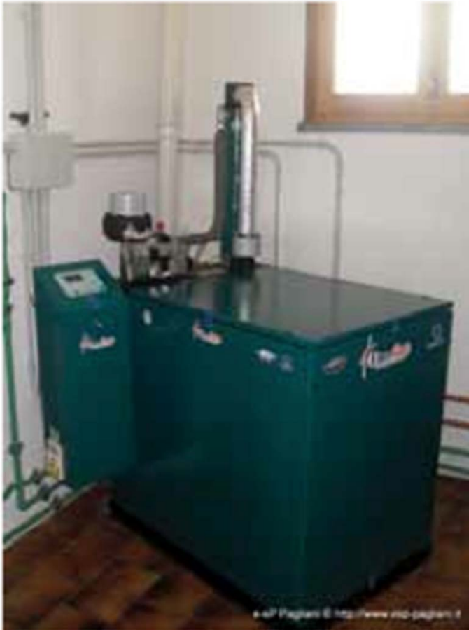
Cogeneratore di piccola taglia per utenze condominiali
